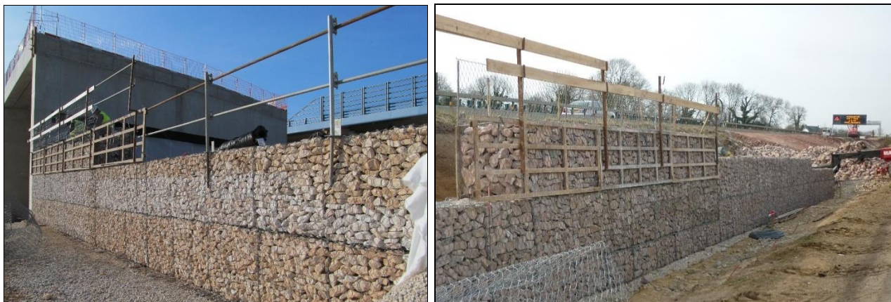
37 pav. Apsauginė įranga ant TMS sistemos blokų (pavyzdžiai).
