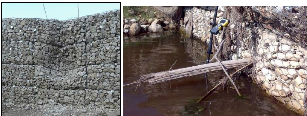
35 pav. Sienos defektai dėl smūgio (kairėje) ir dėl srovės nešamo medžio kamieno (dešinėje).
