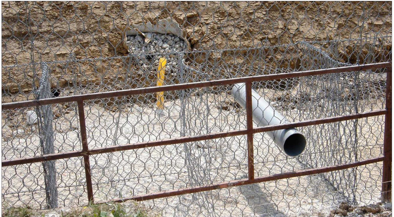
36 pav. Tinką kertantis nedidelio skersmens vamzdis.
